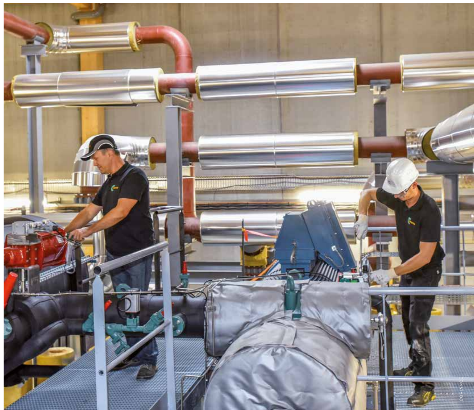
La chaufferie biomasse installée à Saint-Pantaléon-de-Larche (Corrèze) alimente une partie du réseau de chaleur de la ville de Brive depuis 2019.
